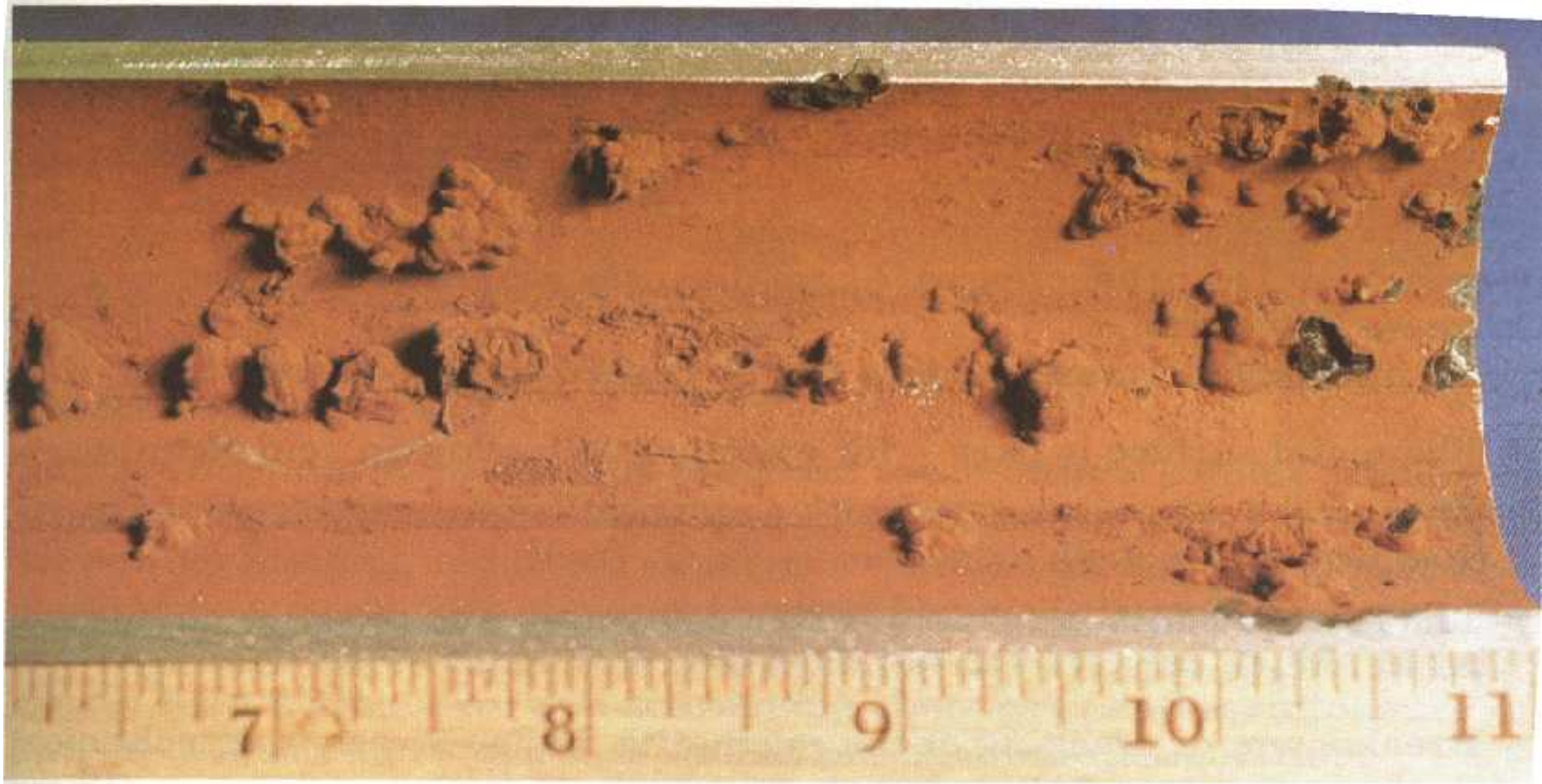
TUBO DE SOBRECALENTADOR DE CALDERA - CORR. POR OXÍGENO
