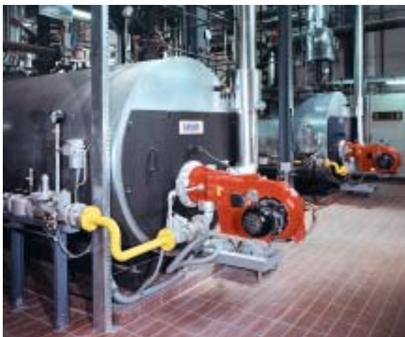
Dos generadores de vapor de baja presión: calderas U-ND con quemador modulante de gas natural
