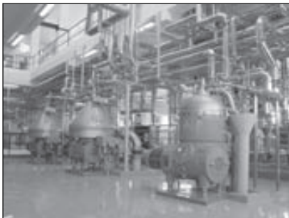
FIGURA 8-41 Red de tuberías en una instalación industrial.
